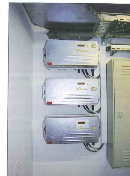
Les onduleurs pour les capteurs thermiques.
