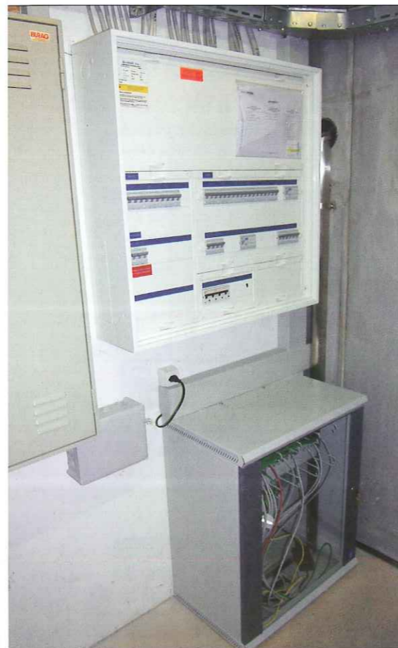
Le local technique est équipé d'un serveur ADSL pour l'ensemble des locataires.
