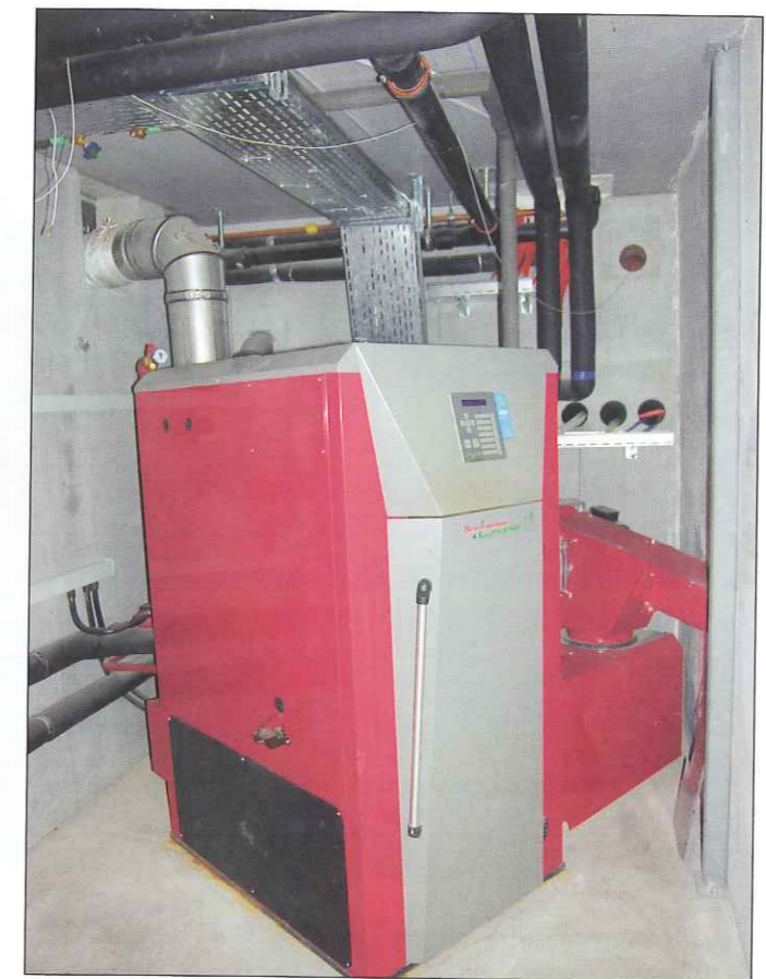
La chaudière à pellets en appoint aux capteurs thermiques.
