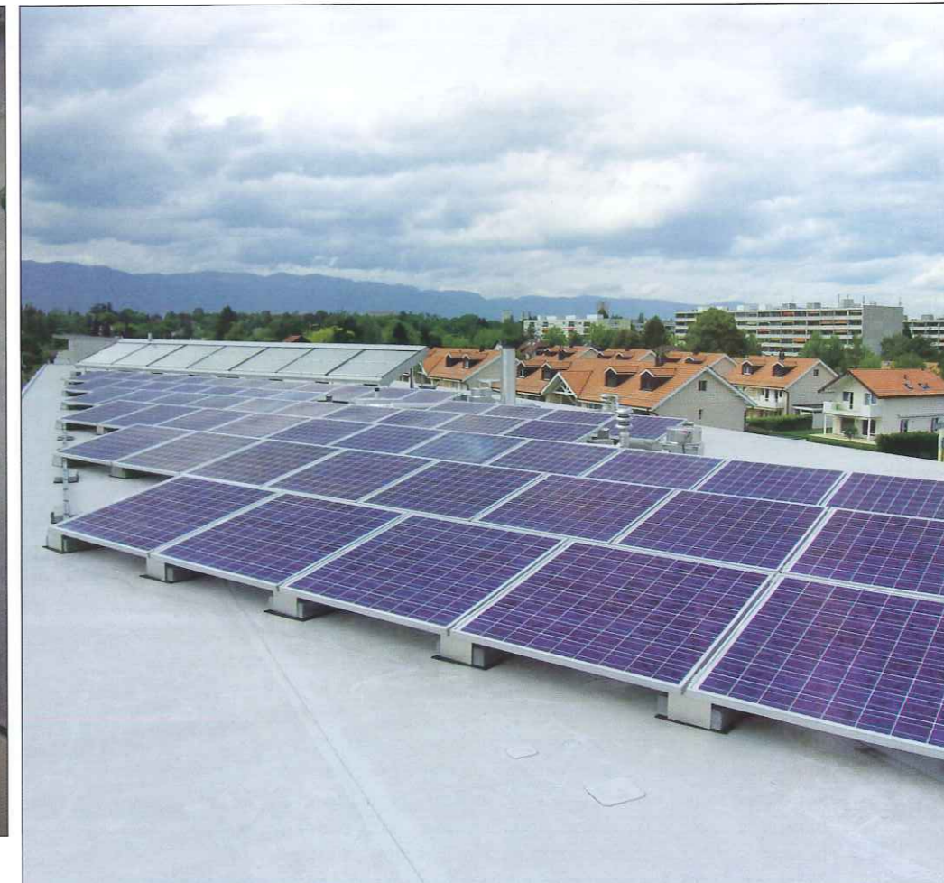
En toiture, quelque 100 m 2 de panneaux photovoltaïques produisent environ 10 000 kWh/an. On distingue au fond les capteurs solaires pour la préparation de l'ECS.
