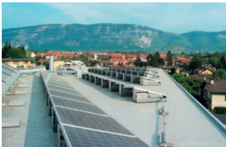
Les panneaux photovoltaïques installés sur la toiture. On devine à gauche les panneaux solaires thermiques qui assurent la totalité de la production d'eau chaude en ce mois d'avril 2007 très doux.
